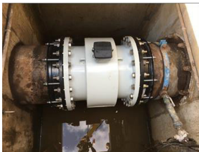
Nouvelle sonde électromagnétique sur poste Saint Loup
