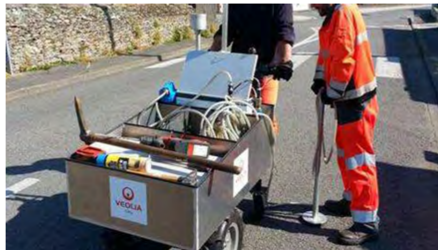
Recherche de fuite par écoute acoustique
