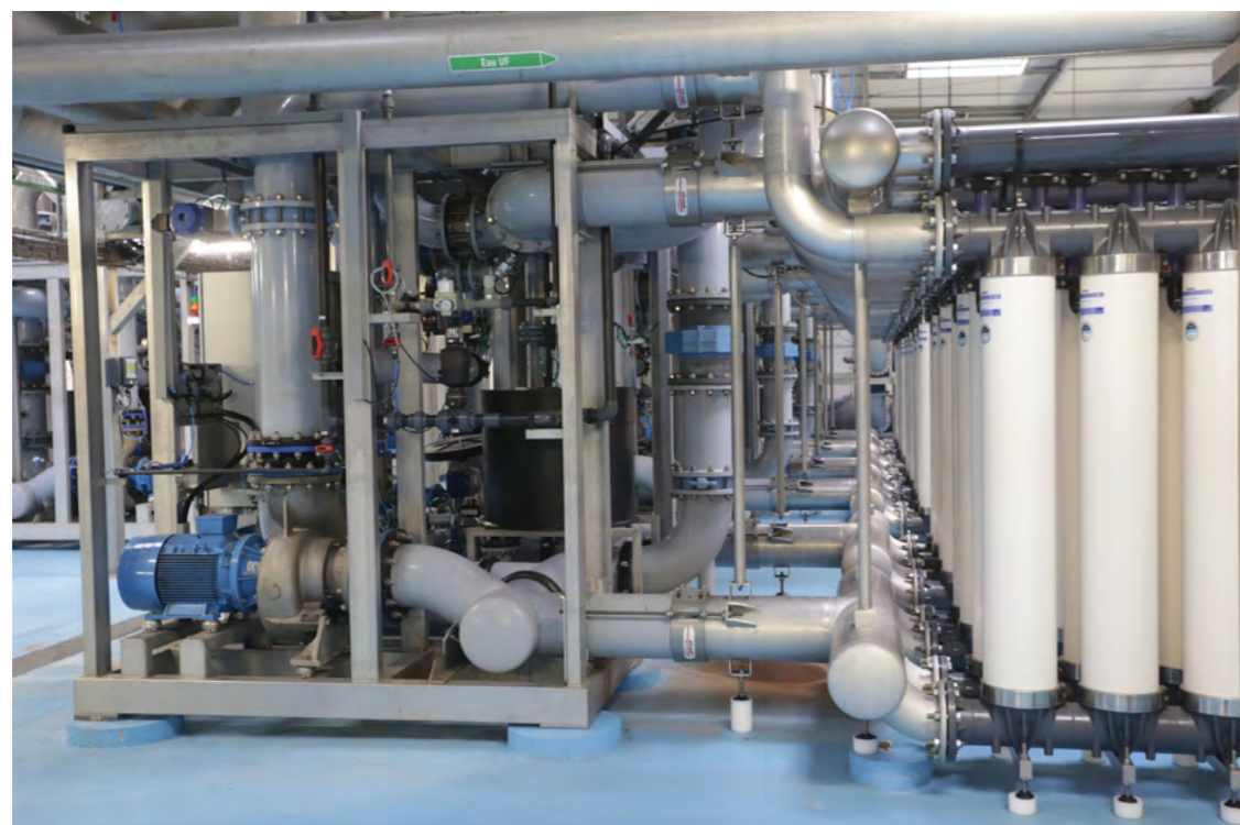
Usine du Val - ultrafiltration
