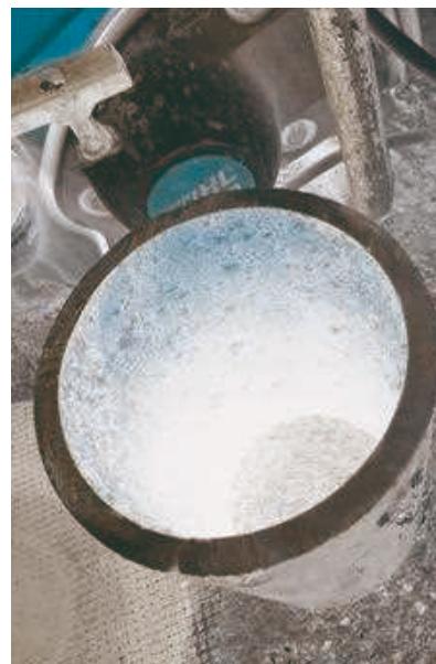
Canalisation en fonte renouvelée (Semoy)
