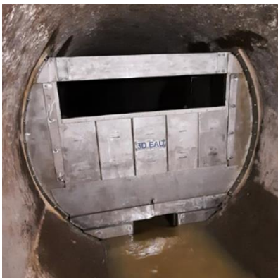
Vanne de stockage à basculement
