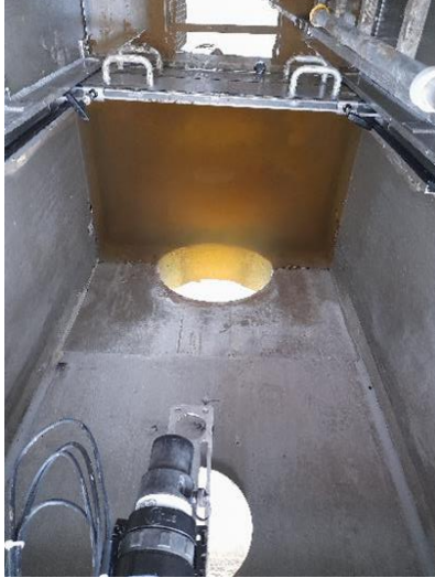
Equiptement exutoire bassin Francis Perrin à Saran
